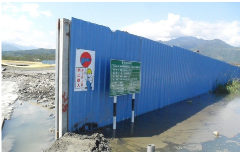
圖 1-17 施工圍籬架設範圍不夠且圍籬支撐強度顯然不牢固 (環保署/提供)
