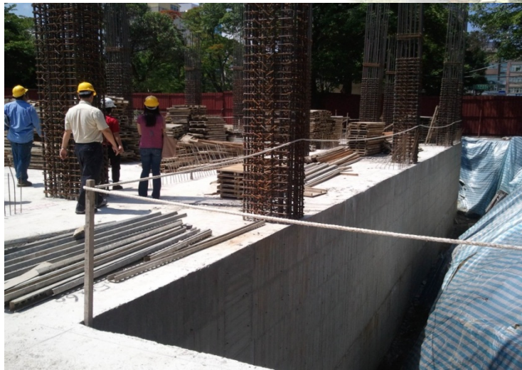
圖 1-16 高差超過 2 公尺工作面之防墜欄杆不符合規定 (廖萬里/提供)
