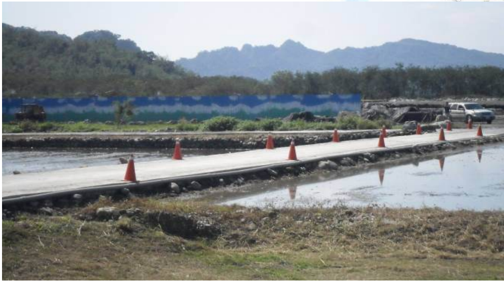
圖 1-18 工地聯外道路易發生人車意外處未設置安全護欄及警示燈 (環保署/提供)
