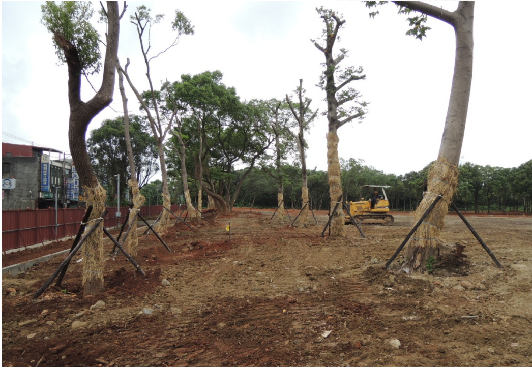
圖 5-21 支架設計不當，支撐力不足以支撐樹木 (環保署/提供)
