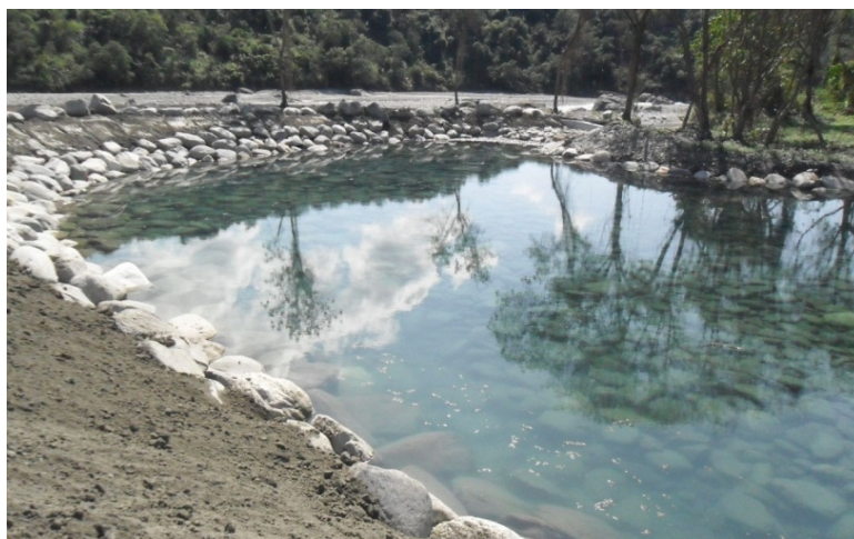
圖 1-14 砌石方向未將長邊砌入邊坡內，造成砌石邊坡易發生滑落現象 (環保署/提供)
