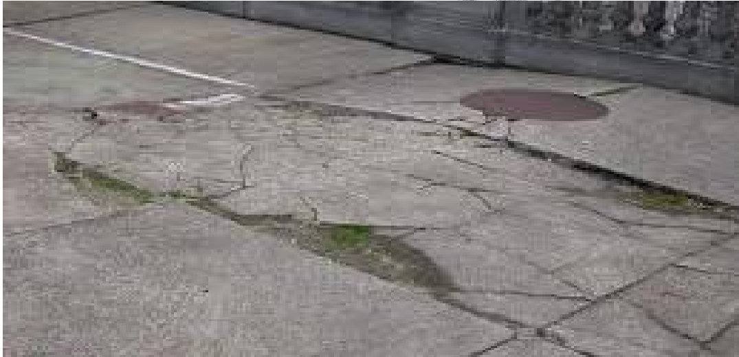
圖 1-5 人行道地磚因底層施工不良無法承受過大荷重造成磚面陷落或突起現象 (廖萬里/提供)
