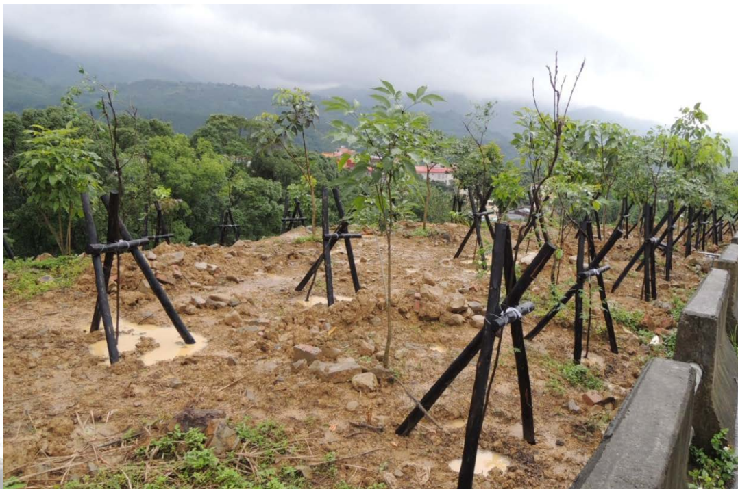
圖 5-28 整地不符合施工規範，未整理出適當坡度，不利排水 (環保署/提供)
