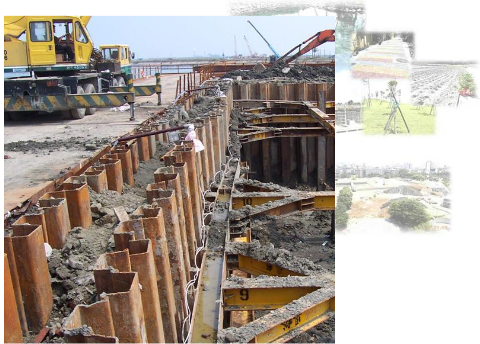
圖 1-1 鋼板樁正確連鎖案例 (廖萬里/提供)
