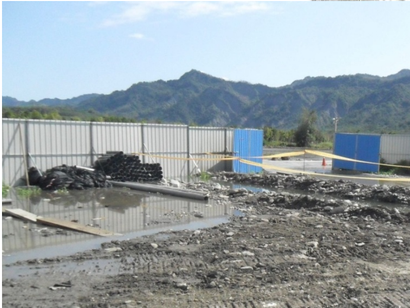
圖 1-20 工地易積水處未設置適當排水設施 (環保署/提供)
