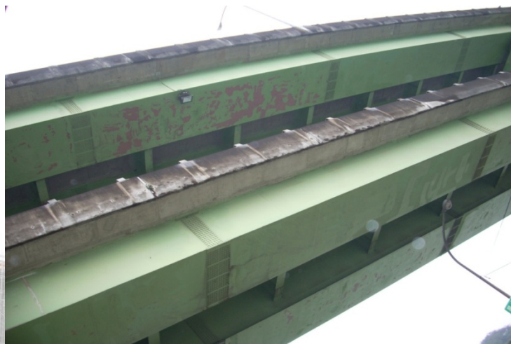
圖 3-21:鋼骨結構未油漆而生鏽 (蘇國樑/提供)
