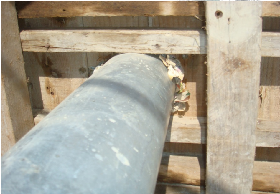
圖 1-4 穿過混凝土槽體之預留管未按照防漏設計圖施工 (廖萬里/提供)
