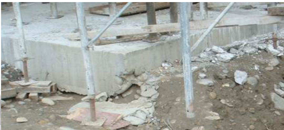
圖 1-2 基礎邊角混凝土澆置不良處可能受到表面水沖刷而淘空造成結構基礎不均勻沉陷 (廖萬里/提供)
