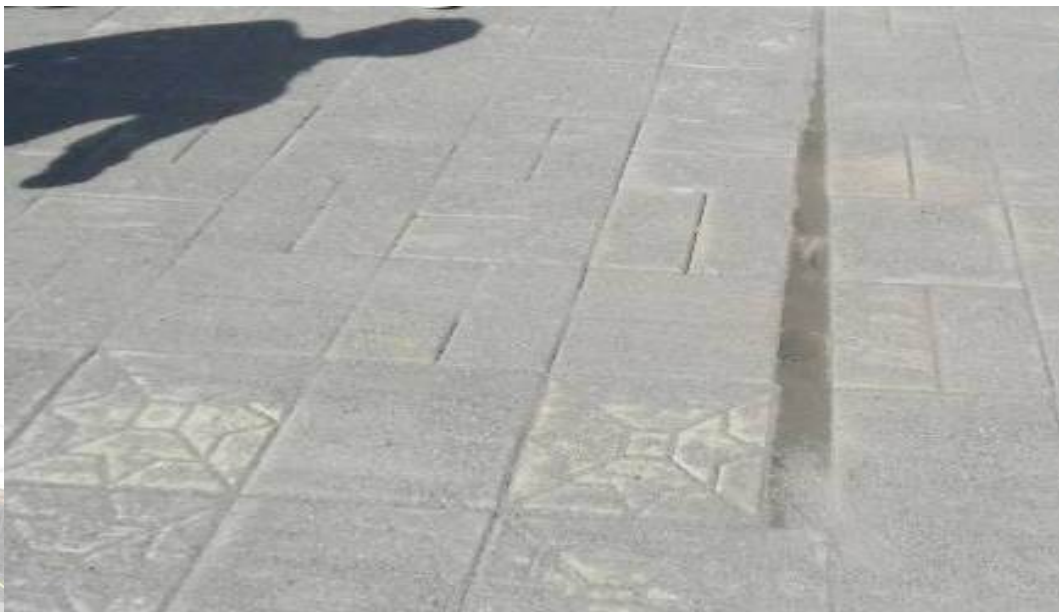
圖 1-6 人行道地磚接縫過大、填縫砂不足或流失 (環保署/提供)
