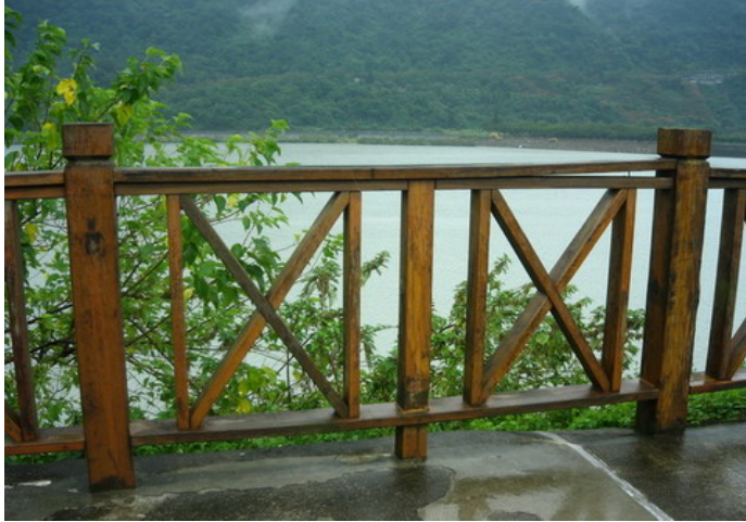
圖 1-12 木製欄杆之橫桿發生彎曲變形 (廖萬里/提供)
