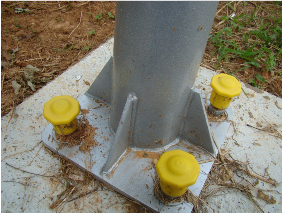
圖 3-29:預埋螺栓過長，切除部分後予以防護 (蘇國樑/提供)
