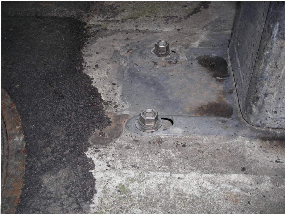
圖 3-30:預埋螺栓長度不足 (蘇國樑/提供)
