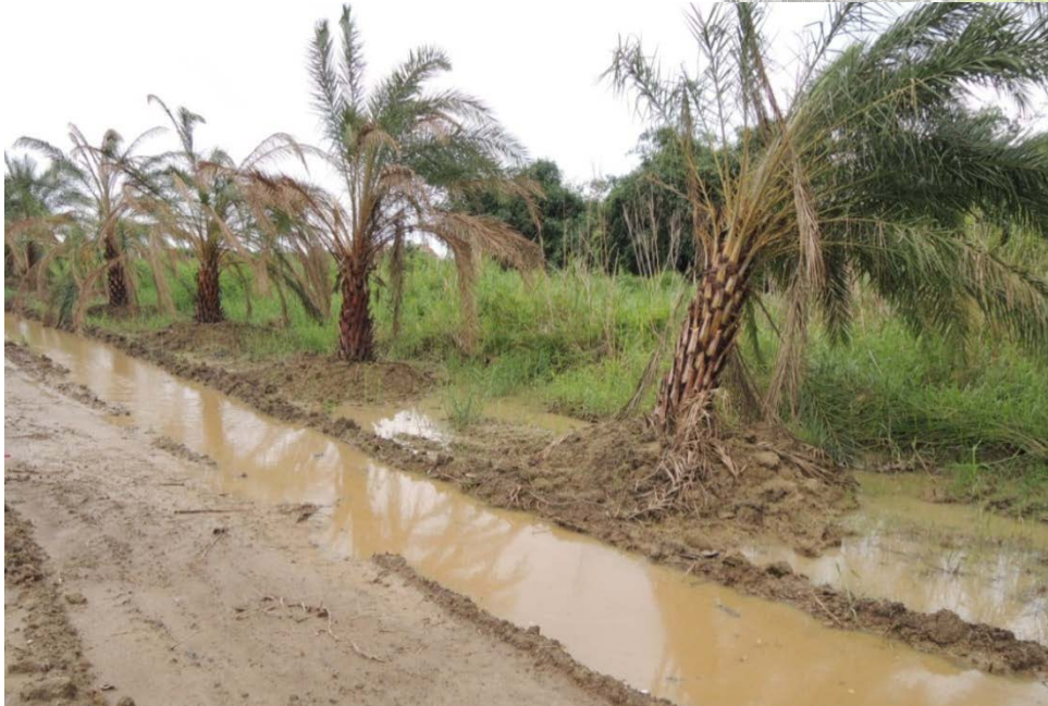
圖 5-23 未依植栽施工計畫書及設計圖說施作，應將種植後的臺灣海棗立即立支柱，以避免植栽傾斜（環保署/提供）
