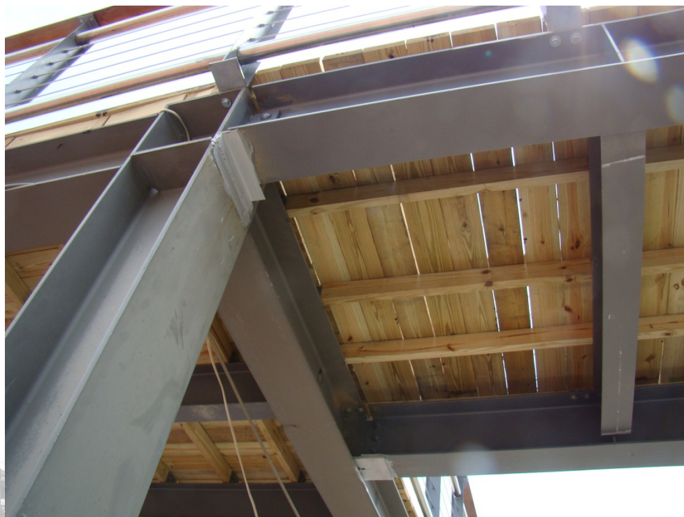
圖 3-26:鋼骨結構銲接不良，必須予以補強 (蘇國樑/提供)
