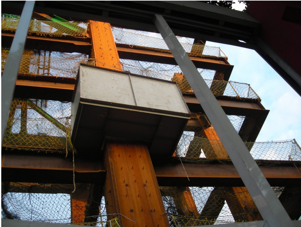
圖 3-27:進行鋼骨結構現場銲接必須予以防護 (蘇國樑/提供)
