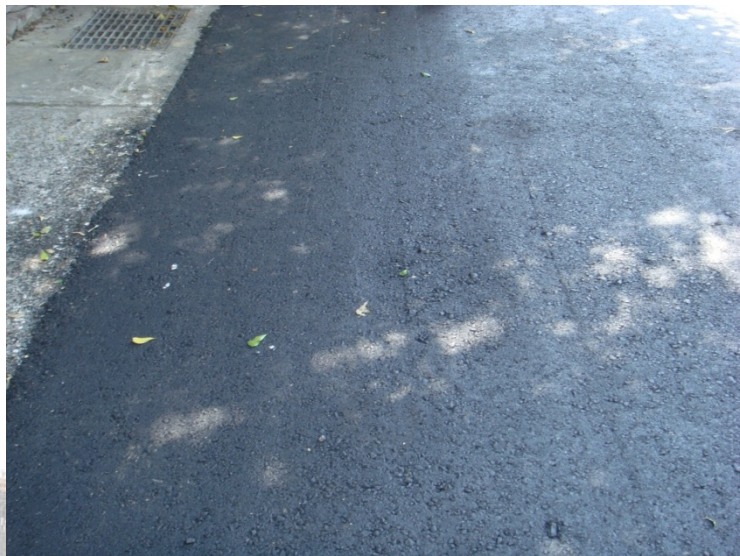
圖 1-8 瀝青混凝土面層之粒料有拌合不勻或粒料析離現象，且鋪設時未有效保護既有水溝蓋 (廖萬里/提供)
