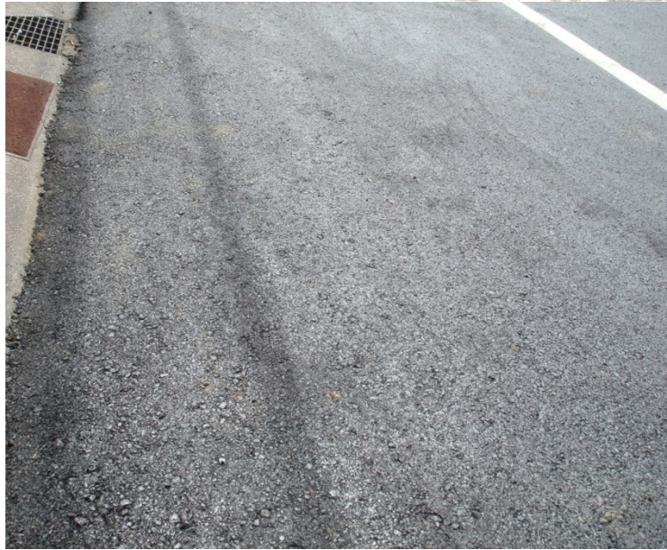
圖 1-7 瀝青混凝土面層與路緣結合處之壓實度不佳，鋪設不平整 (廖萬里/提供)
