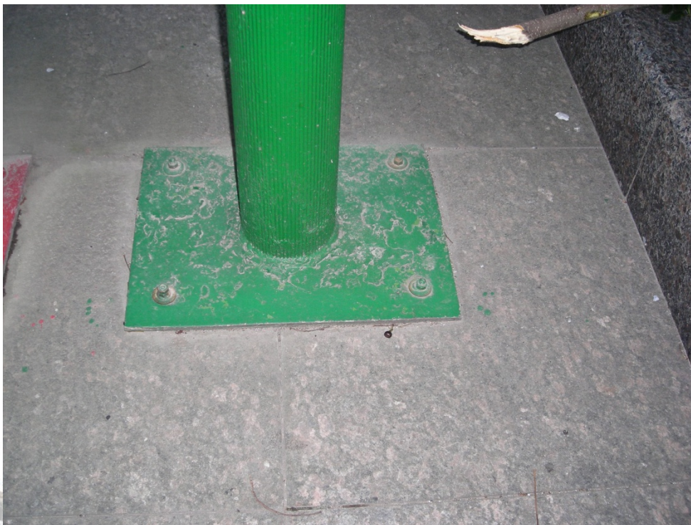
圖 3-32:柱底板直接與地面接觸，容易生鏽 (蘇國樑/提供)
