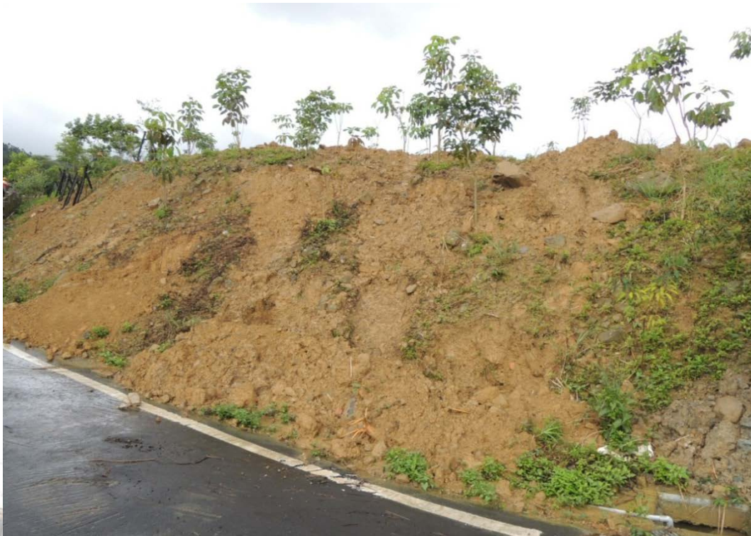
圖 5-30 未作邊坡保護即種植喬木，造成土石滑落 (環保署/提供)
