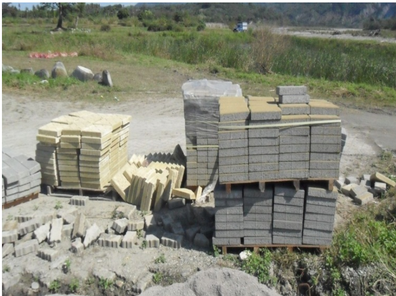
圖 1-21 工地材料堆置凌亂且未有材料保護措施 (環保署/提供)
